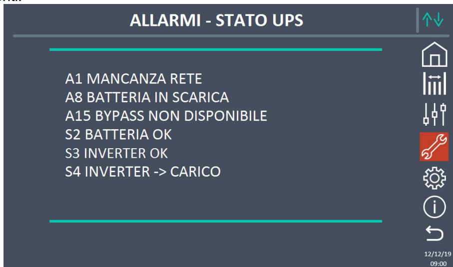
Figura 13 – Sezione allarmi, stato UPS
