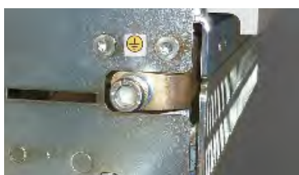
Point de connexion sur base débrochable
