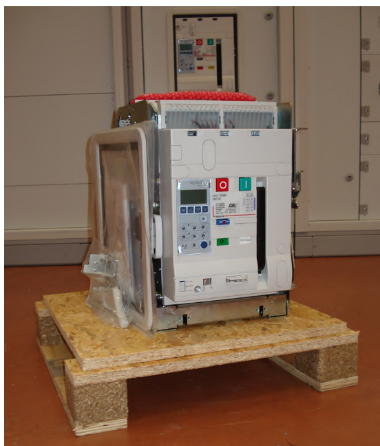
Les appareils sont fixés sur une palette
