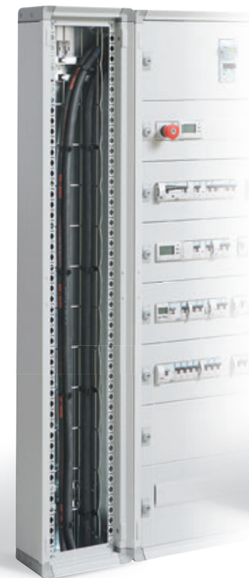
Gaine externe équipée d'un chemin de câbles
