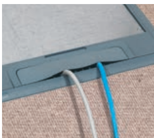
Flexibele uitvoer van de kabels.
