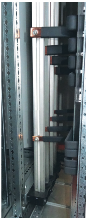
Jeu de barres installé en gaine à câbles.
